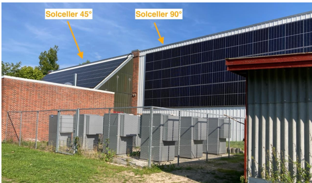
Figur 4: Nogle af Espergærde Gymnasiums solceller. Bemærk, at nogle solceller er placeret på skrå ( 45^\circ i forhold til vandret), nogle er placeret lodret ( 90^\circ i forhold til vandret).
