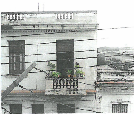
Faldefærdige huse i Havanna.
